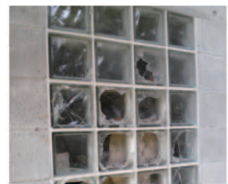
いたずらで割られた倉庫のガラス
